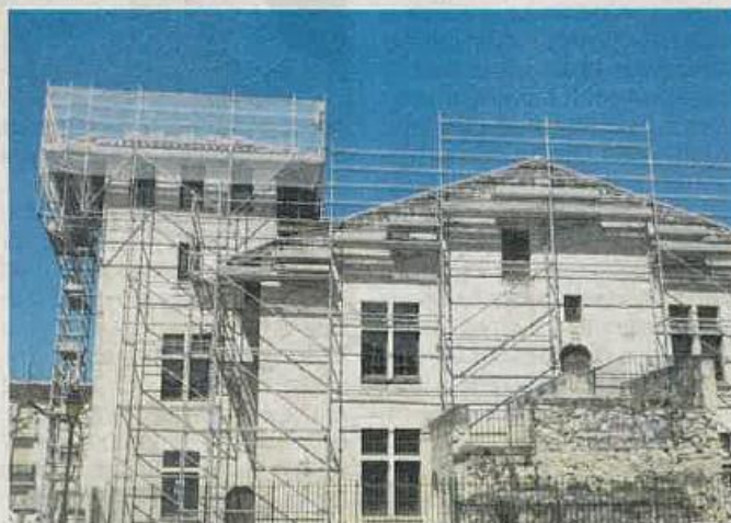
La Maison du Roy entourée d'échafaudages pour la réfection de la toiture. PHOTO M.C.
